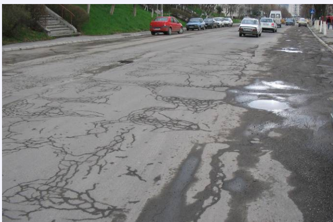
Suprafață existentă deteriorată cu penetrare vizibilă a apei între straturi prin fisuri
