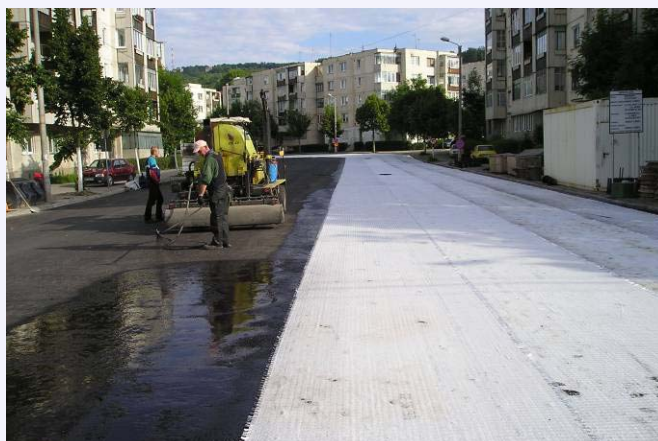
Stratul de egalizare este deja instalat; emulsia este stropită doar pe lățimea unei role de geosintetic
