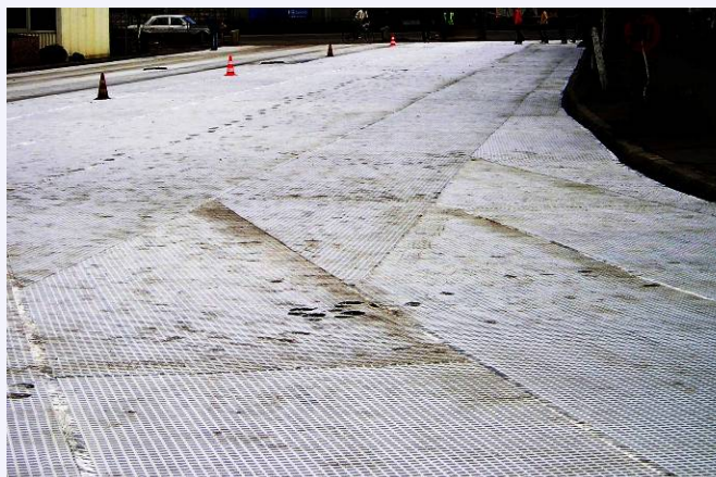
Materialul geocompozit este instalat fâșie lângă fâșie pe toată suprafața fără a fi necesară suprapunerea acestuia
