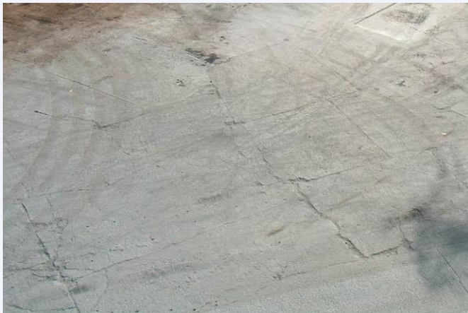
Suprafața puternic fisurată
